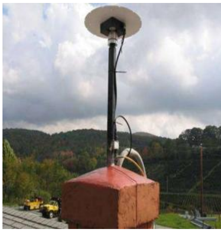
Slika 21 – Antena montirana na krovu
