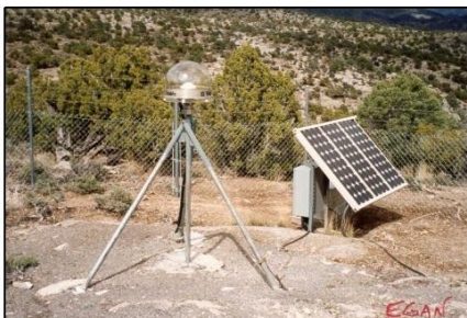
Slika 22 – Antena montirana pomoću metalnih cevi
