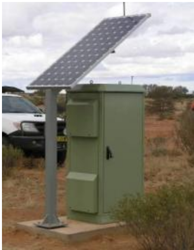
Slika 17 – Solarni panel koji stavlja kućište u senku
