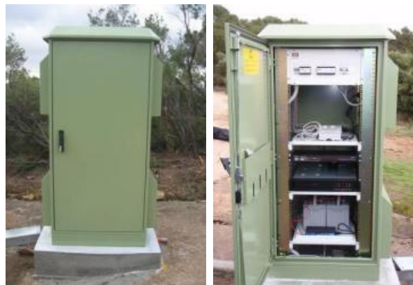
Slika 15 – Oprema postavljena unutar zaštitnog kućišta
