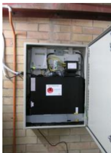
Slika 16 – Oprema postavljena unutar zgrade
